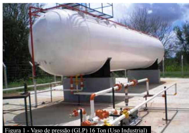
Figura 1 - Vaso de pressão (GLP) 16 Ton (Uso Industrial)
